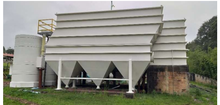
Figura 19: Vista geral com destaque aos módulos metálicos de floculação e decantação
