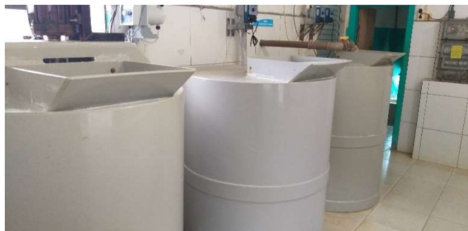
Figura 41: Tanques de agitação/mistura de barrilha, policloreto de alumínio (PAC), flúor e barrilha
