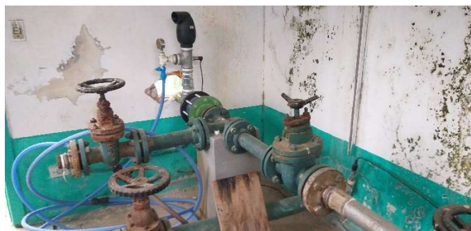
Figura 79: ERAT do Reservatório R2 - CMB
