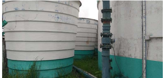
Figura 59: Reservatório R1 - Reservatórios auxiliares de de 20 m 3 (11 unidades)
