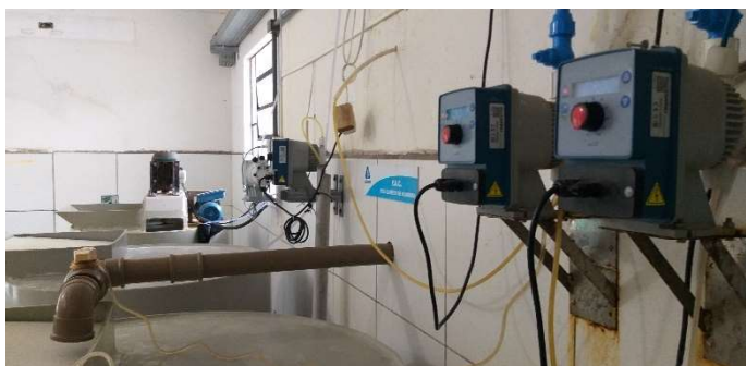
Figura 42: Bombas dosadoras e canalizações para adição de produtos
