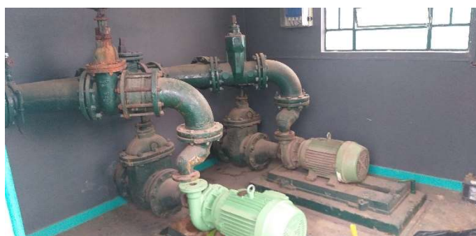
Figura 75: ERAT do Reservatório R1 - CMB
