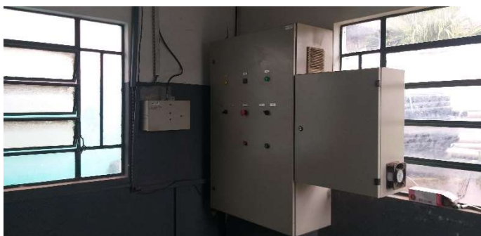
Figura 76: ERAT do Reservatório R1 - Quadros de Comando Elétrico
