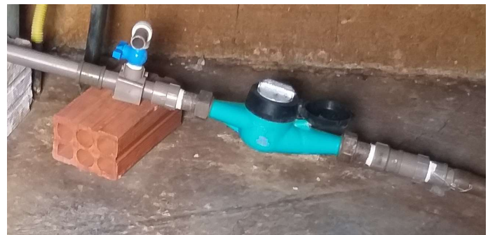
Figura 122: Poço SAA Rio da Estiva - Macromedidor
