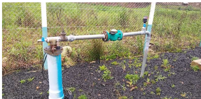
Figura 99: Poço Moema: Poço e barrilete
