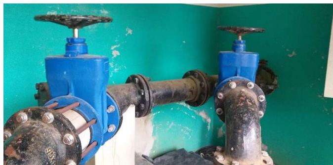
Figura 16: Barriletes e registros do recalque
