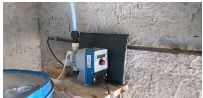
Figura 120: Poço SAA Rio da Estiva - Bomba dosadora de fluor
