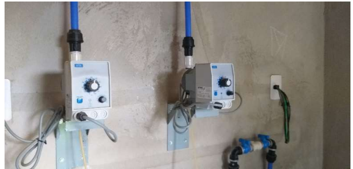
Figura 107: Poço Moema: Casa de Química - bombas dosadoras
