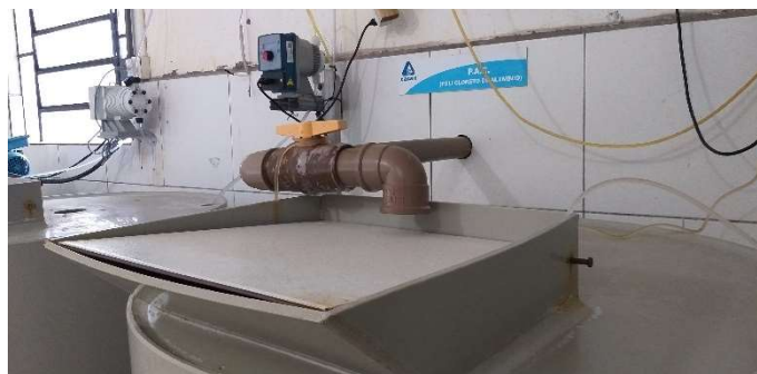
Figura 43: Bombas dosadoras e canalizações para adição de produtos
