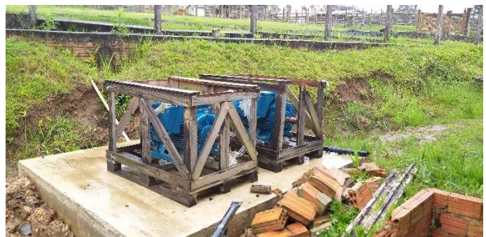
Figura 53: Motores aguardando a substituição dos atuais motores quando da reforma futura da ERAT
