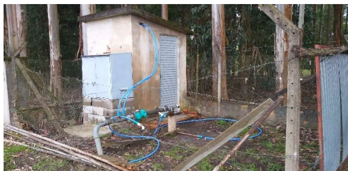
Figura 83: Poço do Bairro Lucena - visão geral
