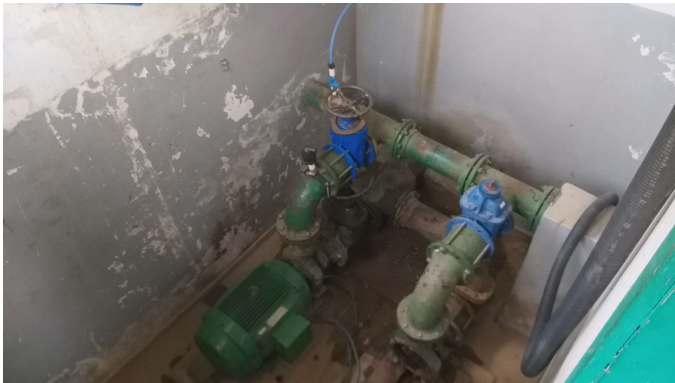
Figura 50: Conjunto motobombas acoplados à linha de sucção do tanque de contato
