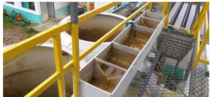
Figura 29: Caixa de distribuição de água decantada para os filtros
