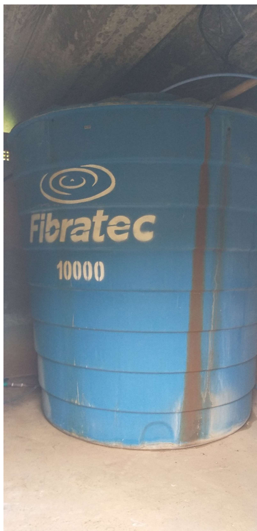
Figura 123: Poço SAA Rio da Estiva - Tanque de Contato
