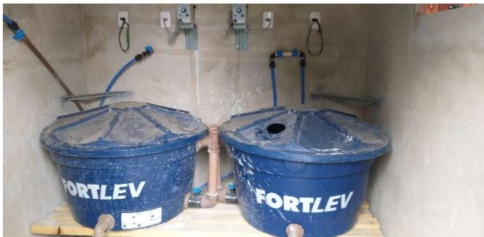
Figura 108: Poço Moema: Casa de Química/Tanques de mistura
