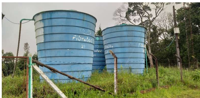
Figura 110: SAA Moema - Reservatórios
