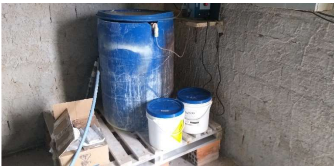
Figura 119: Poço SAA Rio da Estiva - Tanque de mistura do fluor
