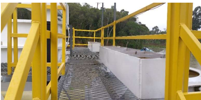
Figura 32: Equipamentos de segurança e acesso.
