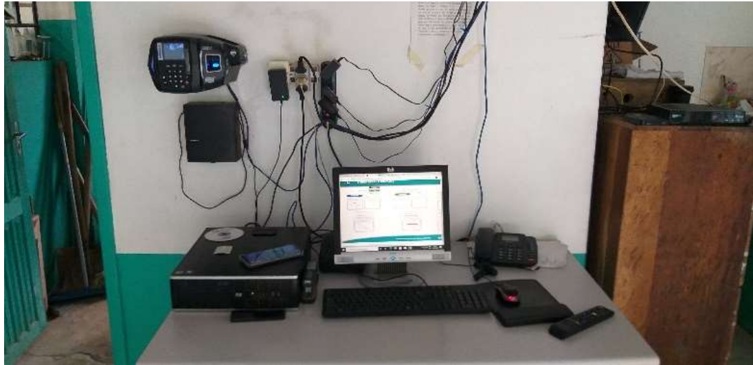
Figura 95: Central de Controle da ETA
