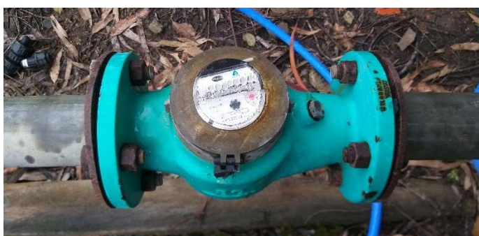
Figura 86: Poço do Bairro Lucena - macromedidor
