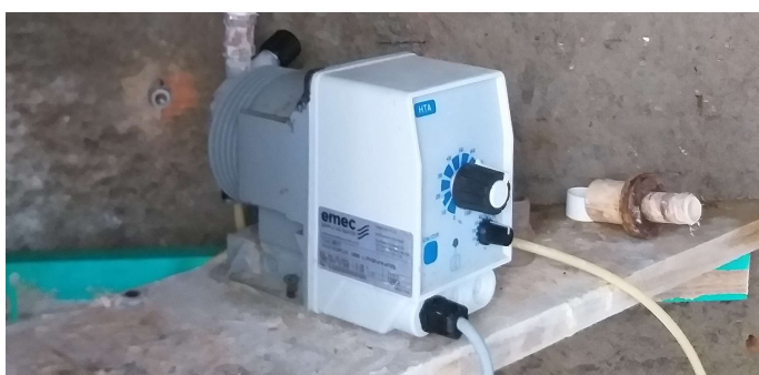
Figura 87: Poço do Bairro Lucena - bomba dosadora
