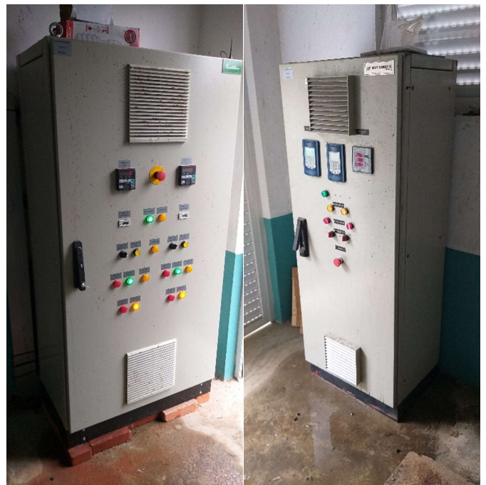
Figura 105: Poço Moema: Quadros de Comando Elétrico
