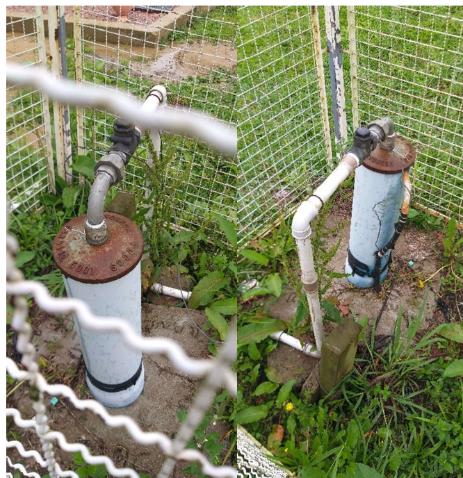
Figura 116: Poço SAA Rio da Estiva - barrilete e grades de proteção
