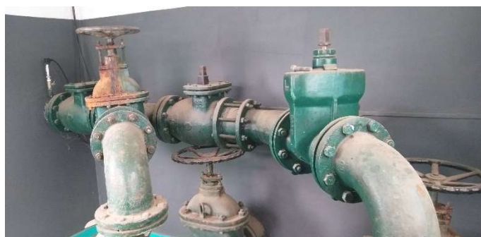
Figura 77: ERAT do Reservatório R1 - Barriletes de recalque do CMB
