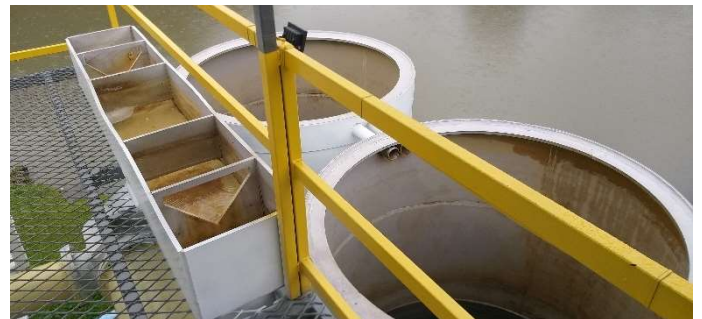
Figura 31: Caixa de distribuição de água decantada para os filtros
