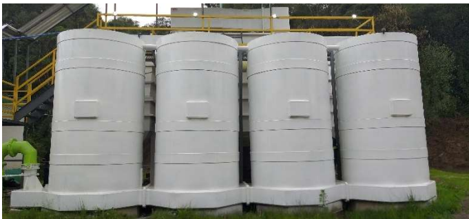
Figura 30: Filtros - visão geral
