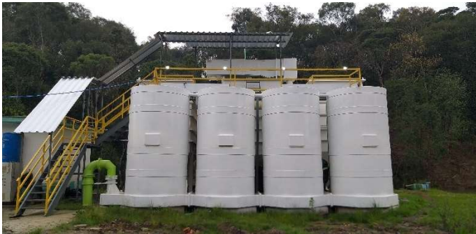
Figura 18: Vista geral com destaque aos módulos metálicos dos filtros
