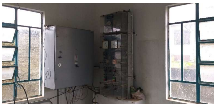
Figura 80: ERAT do Reservatório R2 - Quadros de Comando Elétrico
