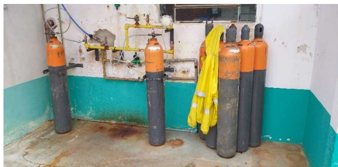
Figura 45: Cilindros de cloro gás, canalizações e equipamentos dosadores
