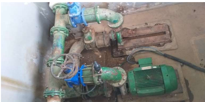
Figura 52: Conjunto motobombas e seus barriletes de recalque
