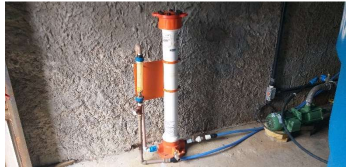
Figura 118: Poço SAA Rio da Estiva - Dosador de Cloro (pastilhas)
