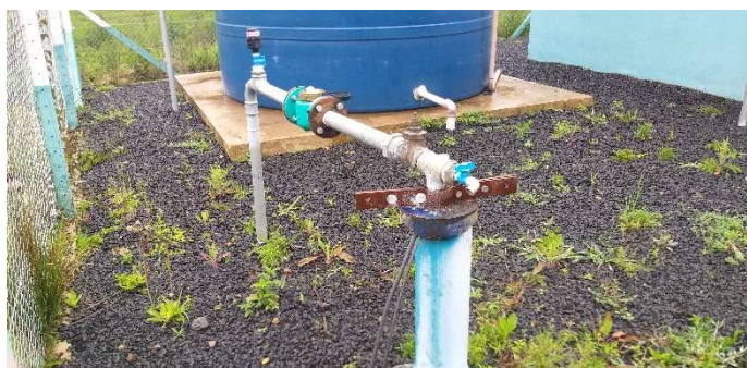
Figura 100: Poço Moema: Poço e barrilete
