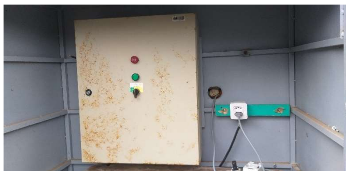
Figura 85: Poço do Bairro Lucena - Quadro de comando elétrico
