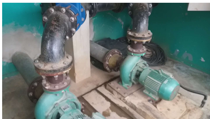
Figura 13: Conjuntos motobombas instalados
