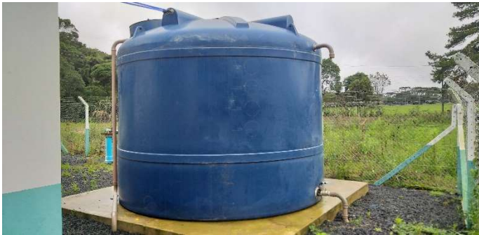
Figura 102: Poço Moema - Tanque de Contato
