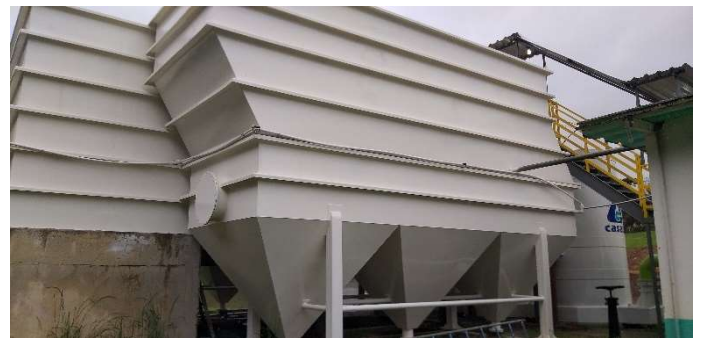
Figura 21: Visão posterior - módulos de floculação e decantação
