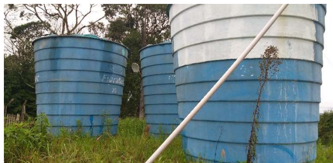
Figura 111: SAA Moema - Reservatórios
