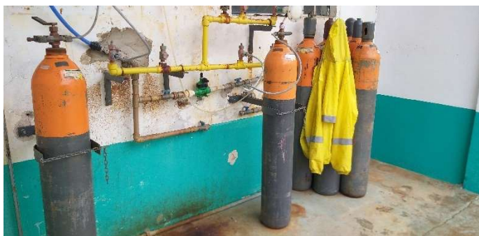
Figura 44: Cilindros de cloro gás, canalizações e equipamentos dosadores
