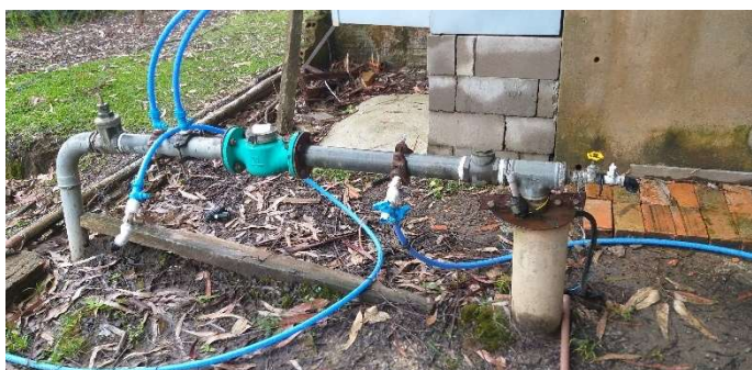
Figura 84: Poço do Bairro Lucena - Barrilete
