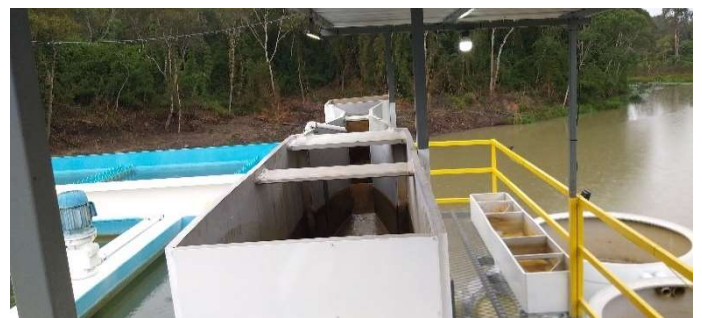
Figura 23: Calha Parshall - vista superior
