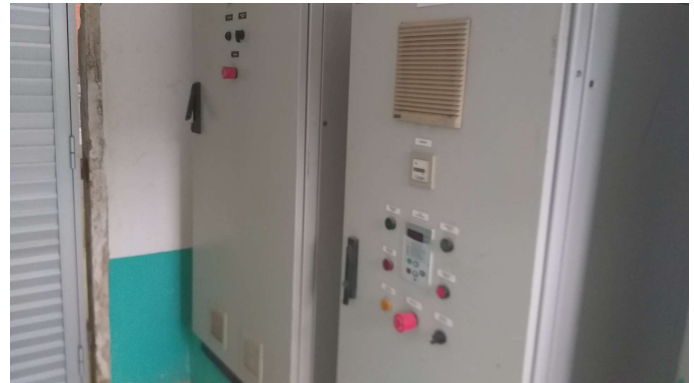
Figura 51: Quadros de comando elétrico
