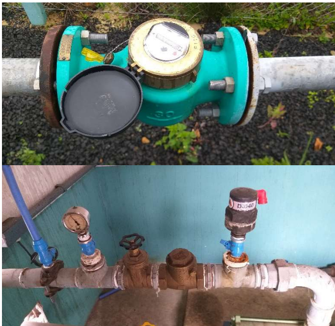
Figura 104: Poço Moema: Macromedidor e linha do recalque da bomba
