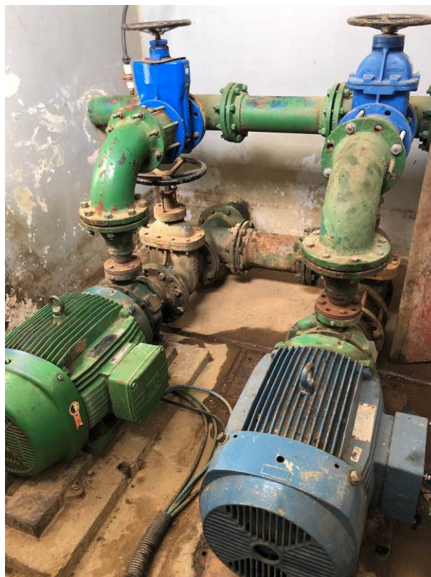
Figura 38: Estação de Recalque de Água Tratada (ERAT)
