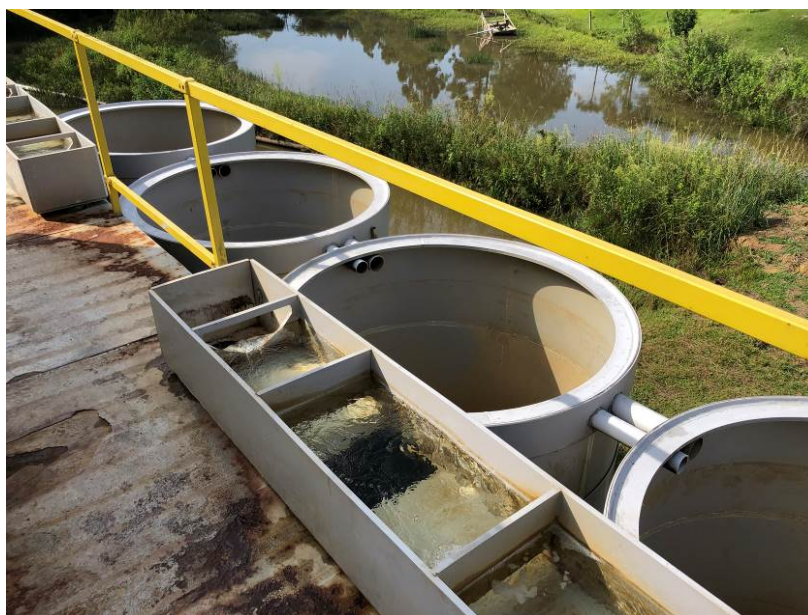
Figura 35: Filtros de Areia
