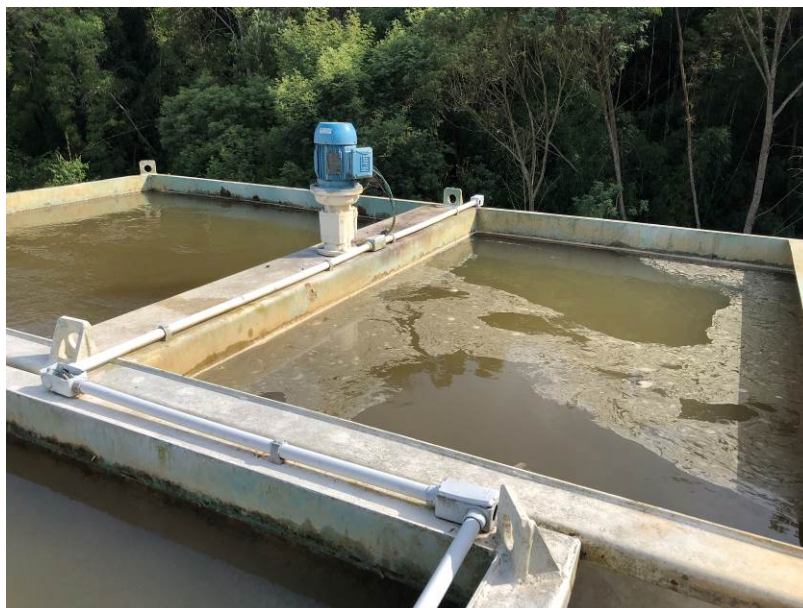
Figura 33: Flocculador Fonte: Arquivo técnico da consultoria, 2019.
