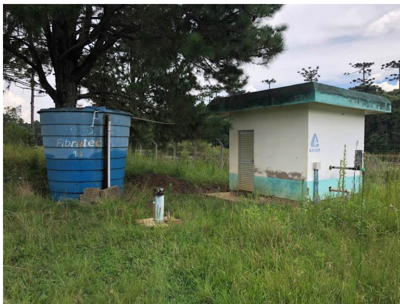
Figura 53: Vista Geral do Poço, Casa de Química e Tanque de Contato Fonte: Arquivo técnico da consultoria, 2019.
