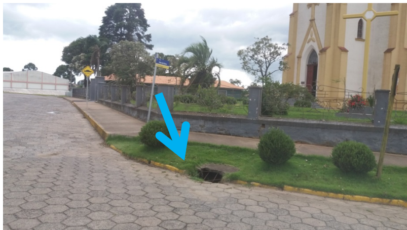
Figura 82: Ponto crítico de drenagem- deficiência no sistema - Ponto 3. Fonte: Arquivo técnico TESE, 2018.
