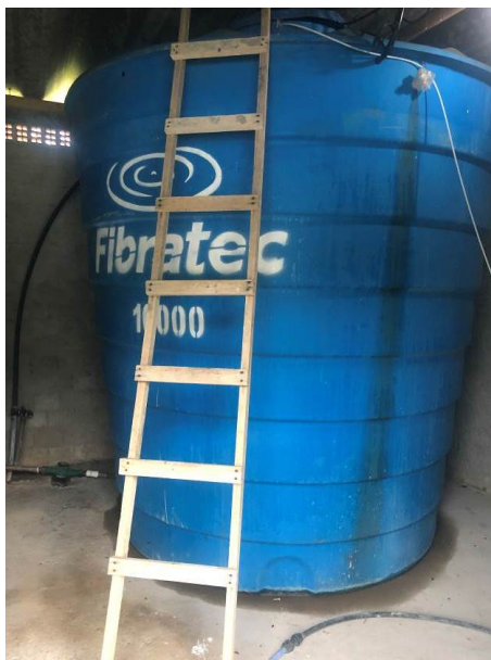
Figura 58: Tanque de Contato
