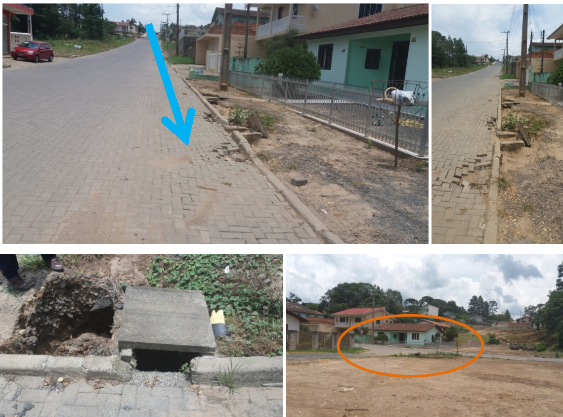
Figura 78: Ponto crítico de drenagem- deficiência no sistema. Ponto 1.
