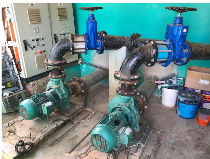
Figura 26: Conjuntos Moto Bomba da ERAB. Fonte: Arquivo técnico da consultoria, 2019.
