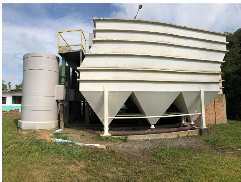
Figura 32: Vista Geral da ETA Fonte: Arquivo técnico da consultoria, 2019.
