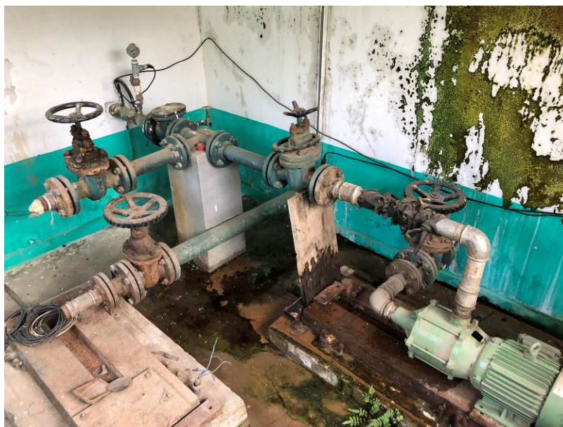
Figura 51: Estado Precário da ERAT (bairro Paraguaçu) Fonte: Elaborado pela Consultoria, 2019.
