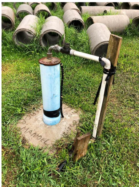
Figura 57: Poço de Captação
