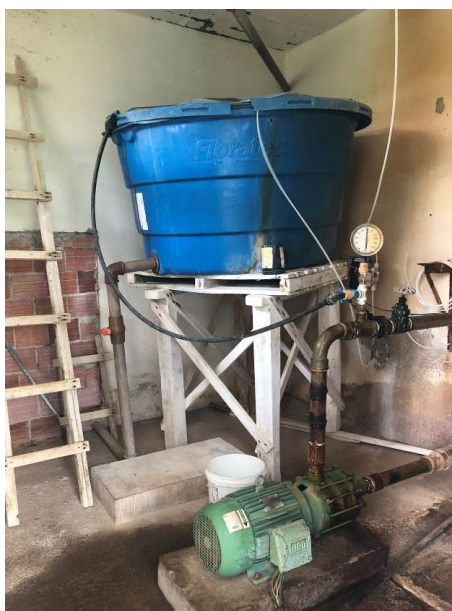
Figura 55: Tina de Produtos Químicos e Recalque de Água Tratada
