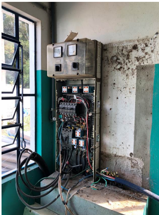
Figura 27: Instalação Elétrica Precária na ERAB Fonte: Arquivo técnico da consultoria, 2019.
