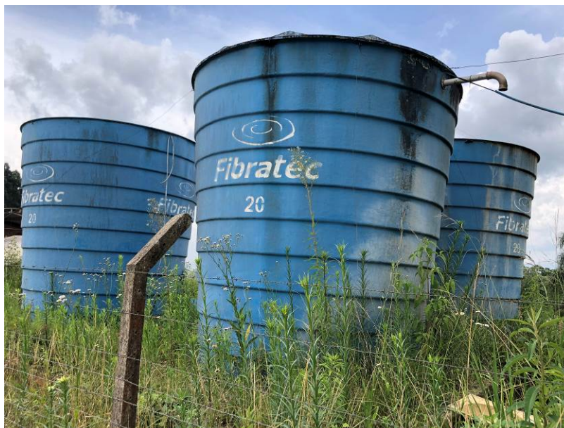
Figura 56: Centro de Reservação do SAA Moema Fonte: Arquivo técnico da consultoria, 2019.
