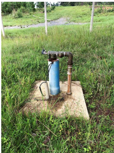
Figura 54: Poço de Captação
