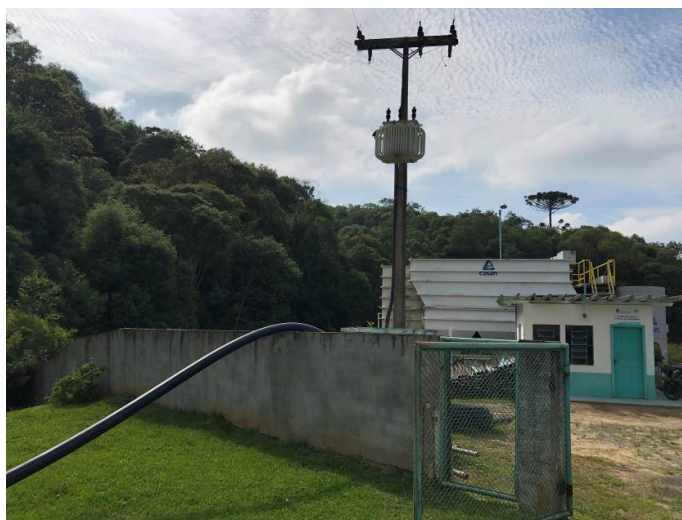
Figura 29: Adutora da Captação de Reforço
