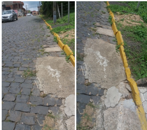
Figura 73: Exemplo de rua com boca de lobo danificada (fechada pela população).
