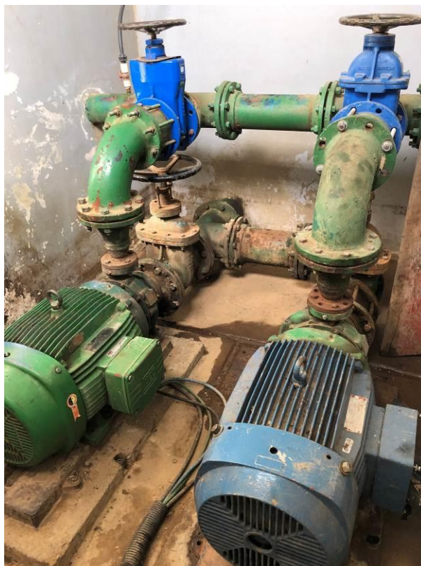
Figura 17: Estação de Recalque de Água Tratada (ERAT)
