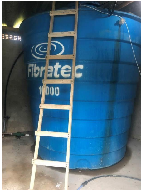
Figura 37: Tanque de Contato
