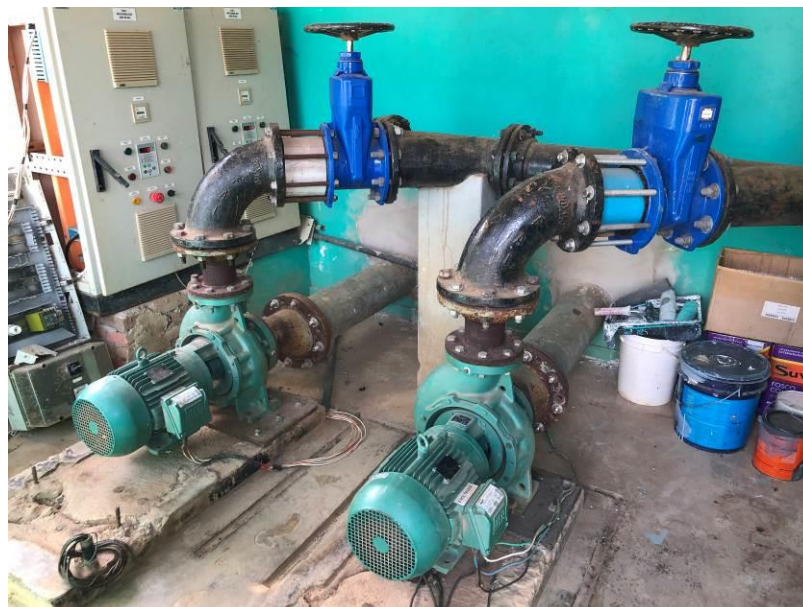
Figura 5: Conjuntos Moto Bomba da ERAB. Fonte: Arquivo técnico da consultoria, 2019.
