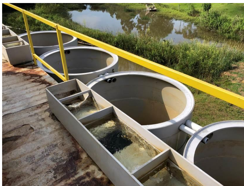
Figura 14: Filtros de Areia
