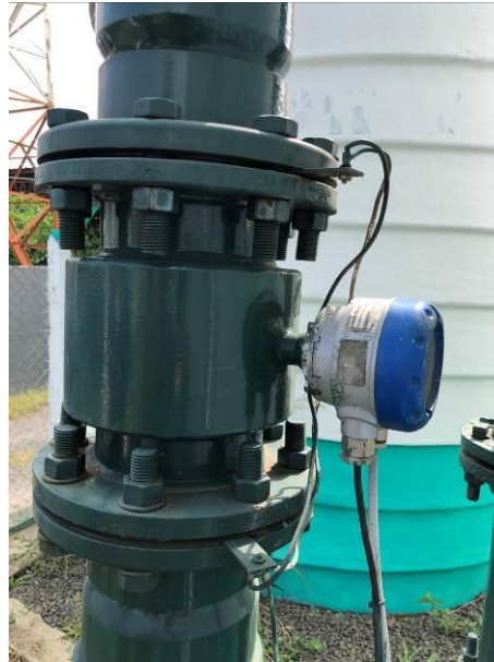
Figura 21: Macromedidor na Entrada do R1 Fonte: Arquivo técnico da consultoria, 2019.
