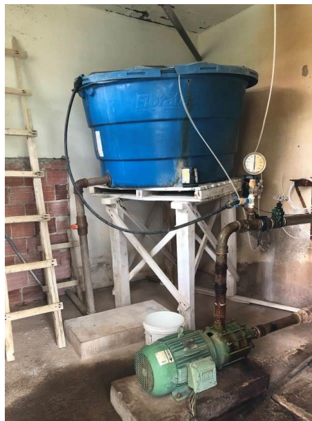
Figura 34: Tina de Produtos Químicos e Recalque de Água Tratada
