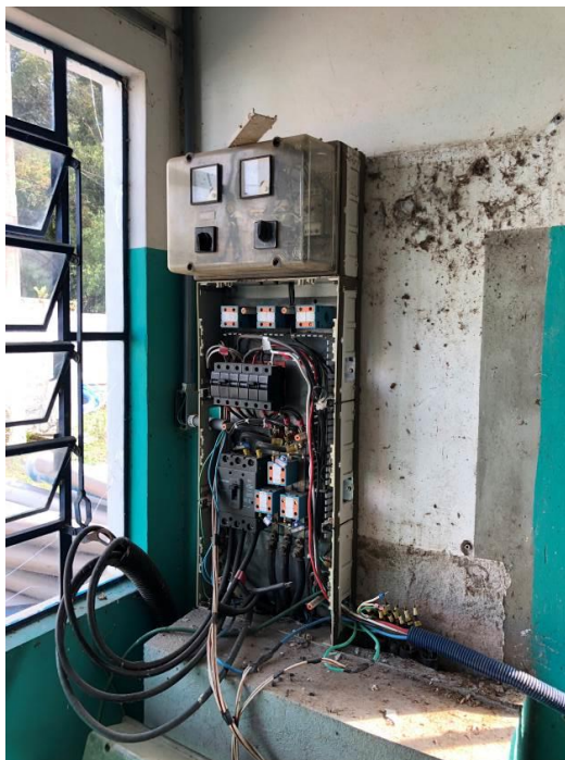
Figura 6: Instalação Elétrica Precária na ERAB Fonte: Arquivo técnico da consultoria, 2019.
