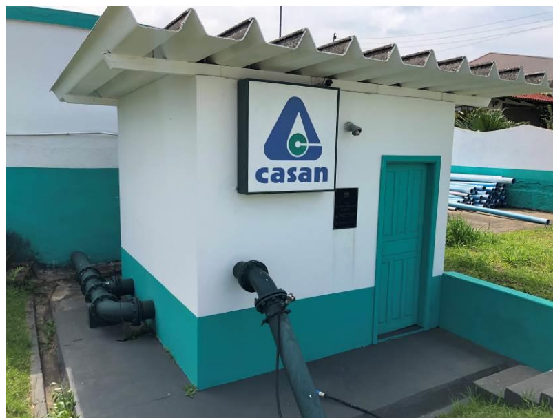
Figura 22: ERAT Localizada Junto ao R1 Fonte: Arquivo técnico da consultoria, 2019.
