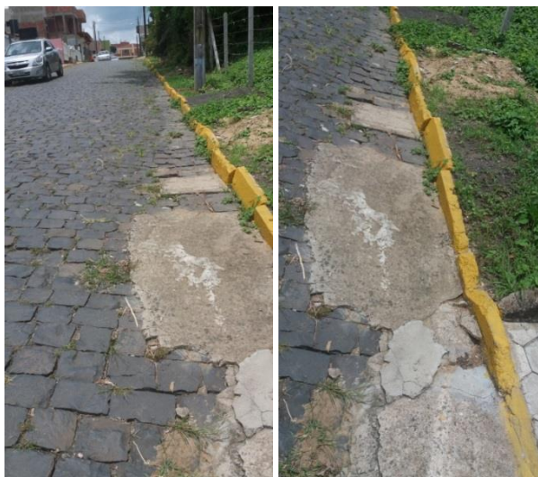
FIGURA 55: BOCA DE LOBO FECHADA COM CONCRETO
