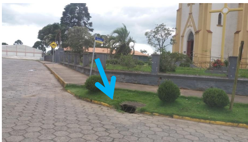
Figura 21: Ponto crítico de drenagem- deficiência no sistema - Ponto 3. Fonte: Arquivo técnico TESE, 2018.
