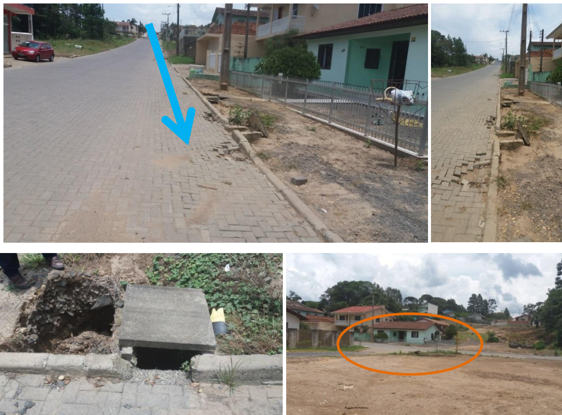
Figura 17: Ponto crítico de drenagem- deficiência no sistema. Ponto 1.
