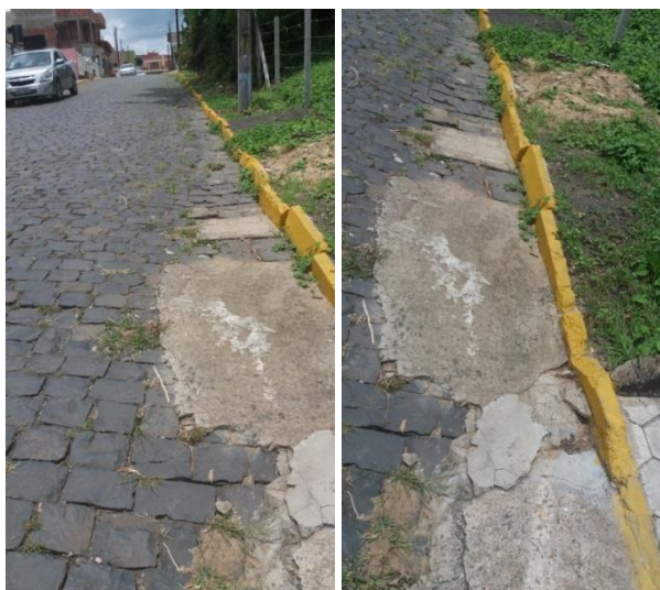
Figura 12: Exemplo de rua com boca de lobo danificada (fechada pela população).
