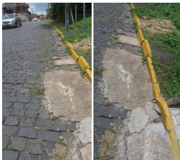
FIGURA 4: BOCA DE LOBO FECHADA COM CONCRETO
