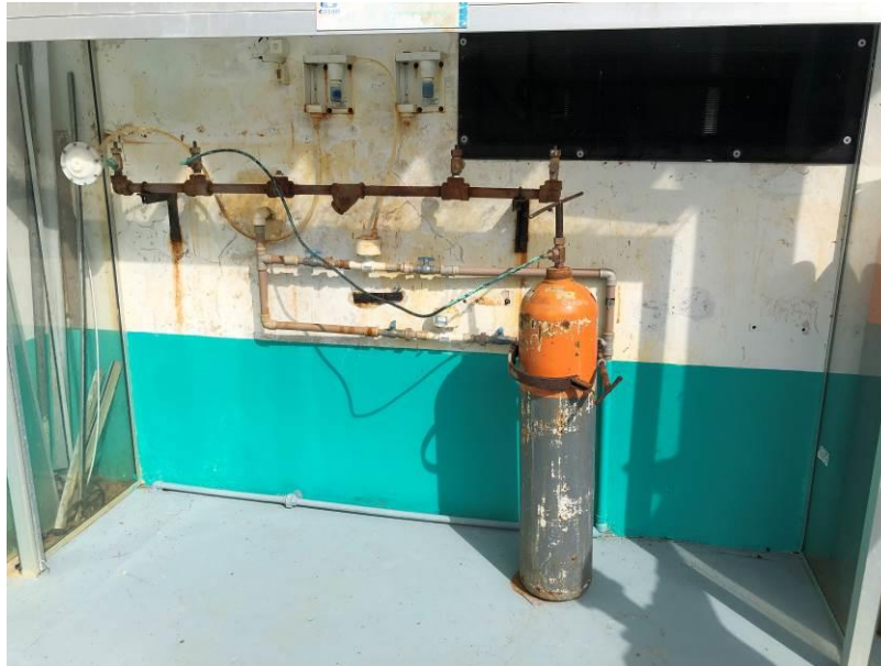
Figura 15: Desinfecção com Cloro Gasoso Fonte: Arquivo técnico da consultoria, 2019.
