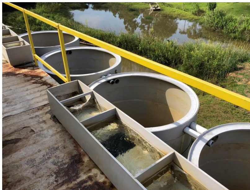
Figura 14: Filtros de Areia
