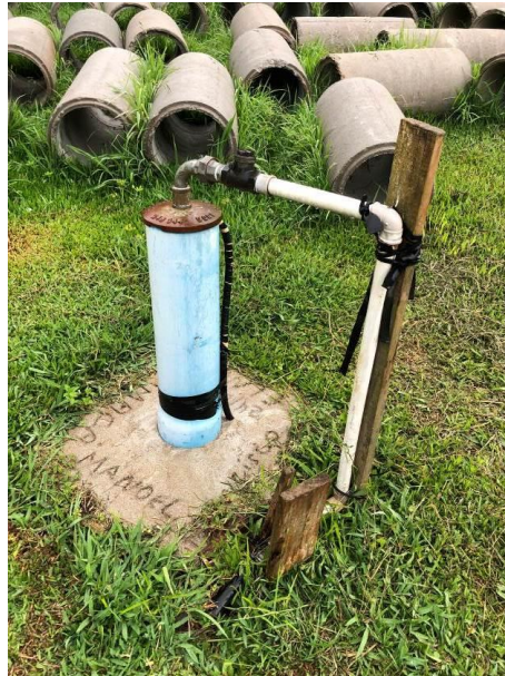
Figura 36: Poço de Captação
