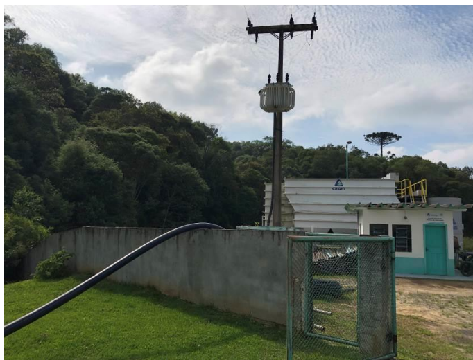
Figura 8: Adutora da Captação de Reforço
