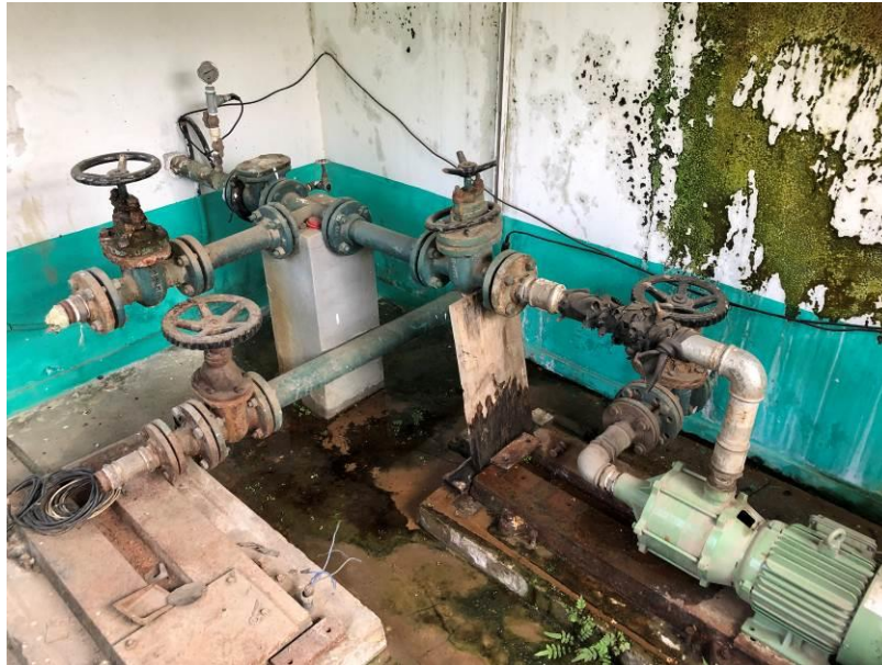
Figura 30: Estado Precário da ERAT (bairro Paraguaçu) Fonte: Elaborado pela Consultoria, 2019.
