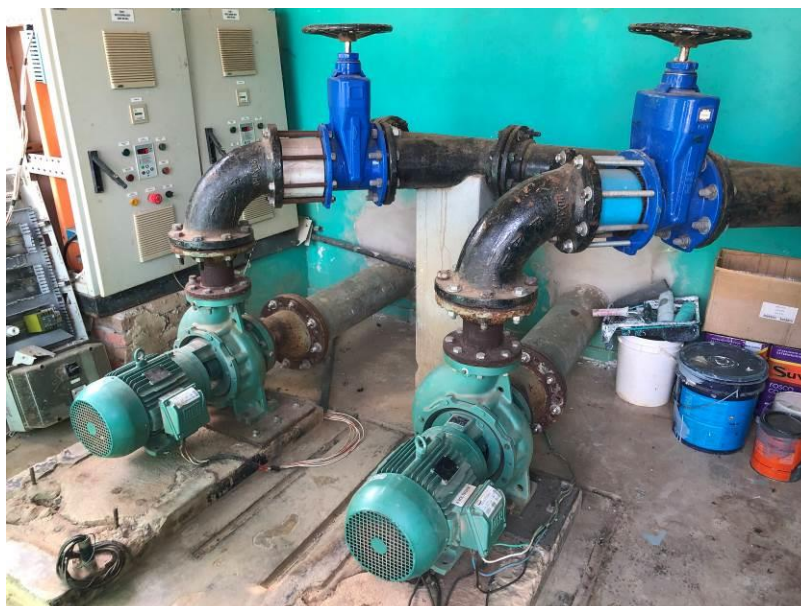
Figura 5: Conjuntos Moto Bomba da ERAB.
