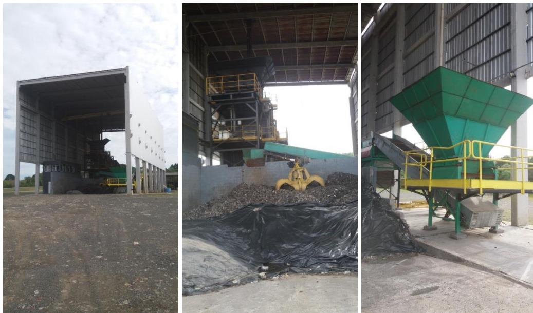
Figura 17: Unidade de Gaseificador de Resíduos – Aterro de Mafra.
