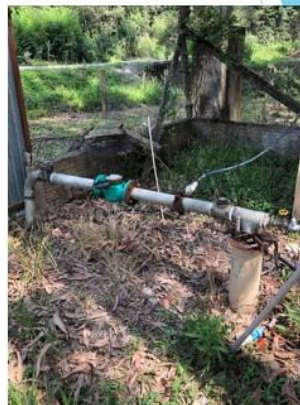
Captação Poço Rio Vermelho
